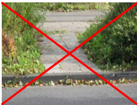
Absenkung über drei Zentimeter
